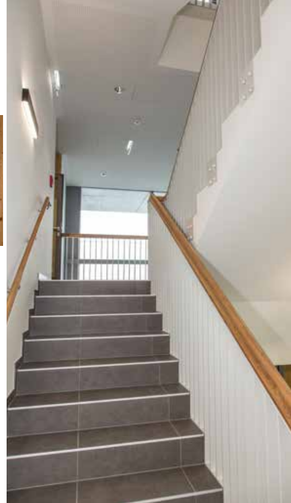
ÖFFENTLICHE BEREICHE. In den Stiegenhäusern wurden Gipskartonlochdecken verbaut und jeder Deckensturz in Trockenbauweise gefertigt.
